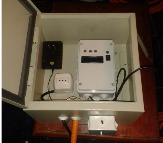
Figura 30: Gabinete metálico (externo) y caja estanca (interna) para la protección del prototipo 2.
