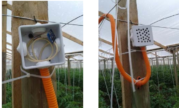
Figura 32: Sensor SHT15 extendido 50 metros dentro de la estructura de los invernaderos.
