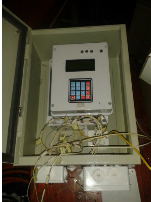
Figura 48: Gabinete metálico (externo) y caja estanca (interna) para la protección del prototipo 3.
