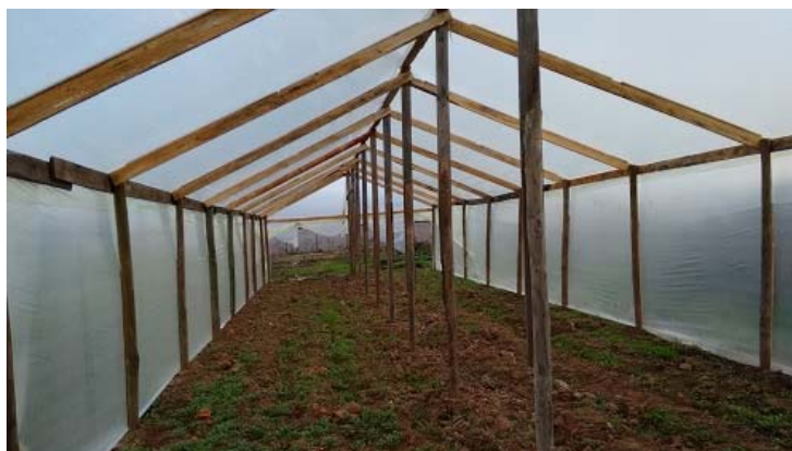
Figura 95: Ejemplo de estructura principal de los invernaderos.
