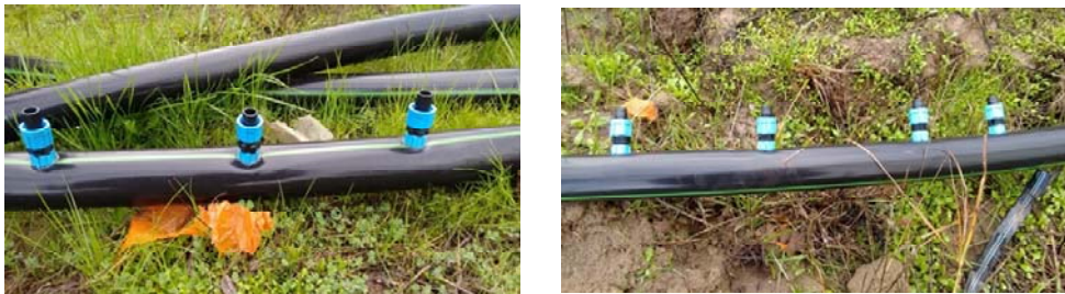
Figura 102: Conectores para cintas de goteo introducidos en la manguera (planza) transportador de agua hacia los invernaderos.
