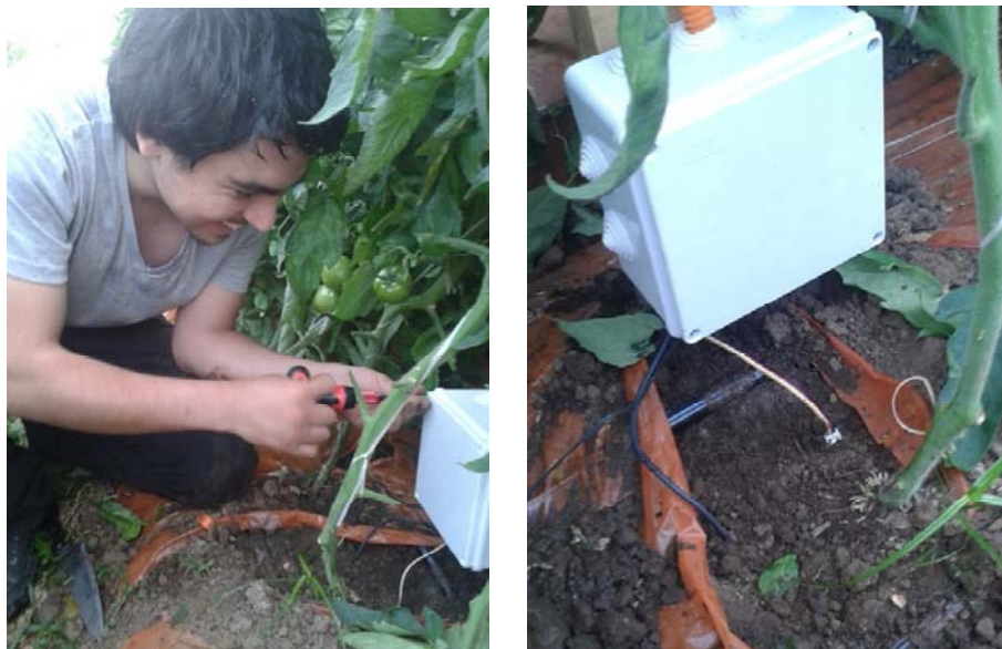
Figura 50: Instalación de los sensores de suelo y agua, prototipo 3.
