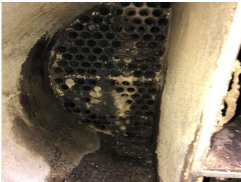
Ilustración 17: Intercambiador de calor con tubos obstruidos
