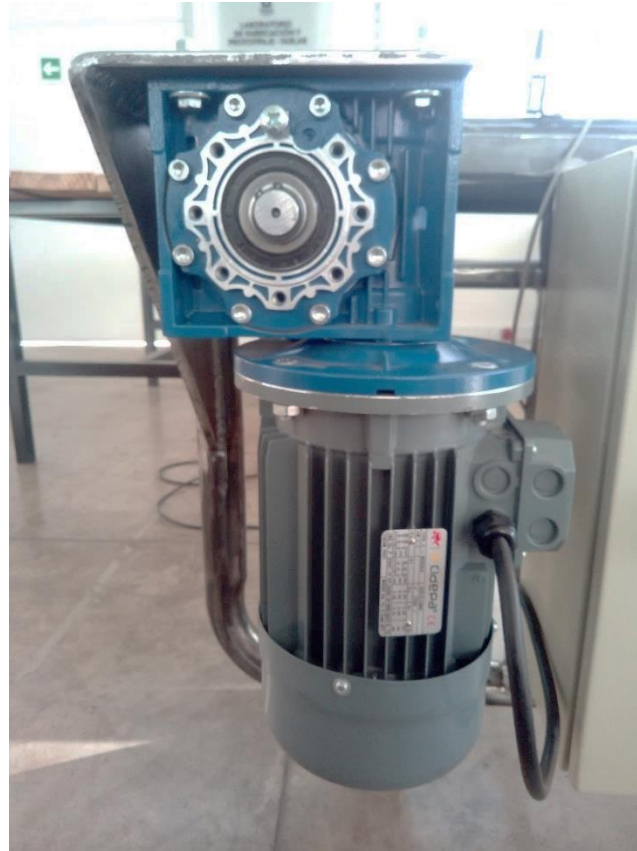
Figura 7.8: Motorreductor instalado en la Cinta Transportadora, Vista 1.
