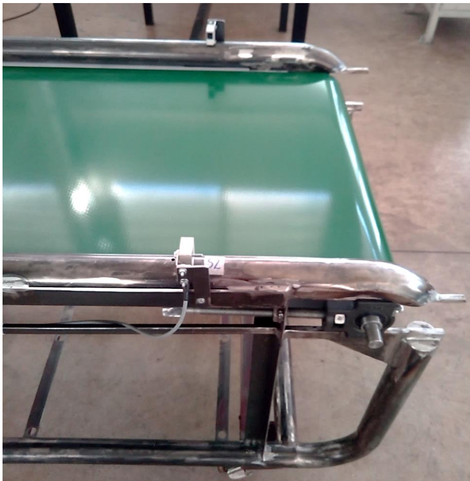
Figura 7.43: Sensores emisor y receptor barrera de luz instalados.
