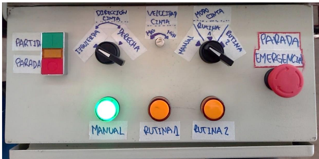
Figura 6.5: Estado del panel de control en modo manual.
