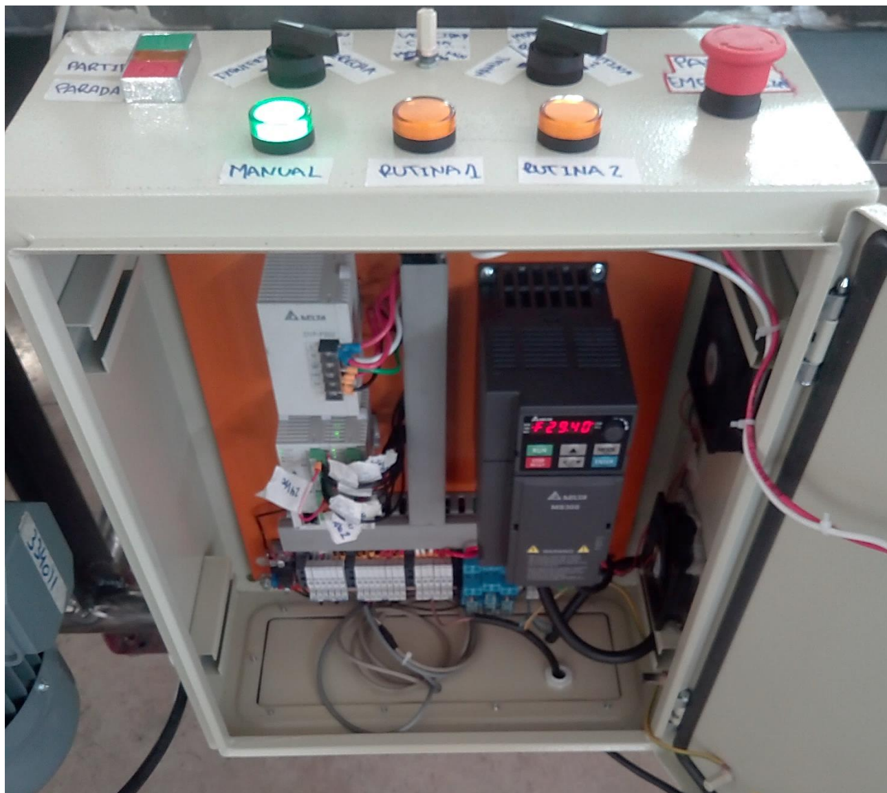
Figura 8.14: Panel eléctrico del banco de automatización de la Cinta Transportadora, vista2.
