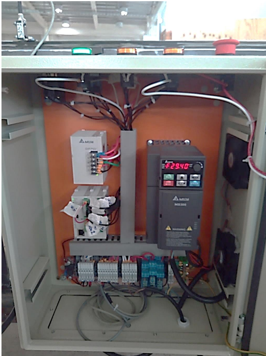
Figura 8.15: Panel eléctrico del banco de automatización de la Cinta Transportadora, vista 3.
