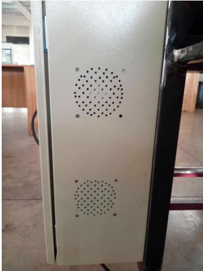
Figura 8.16: Ventilación del panel eléctrico del banco de la Cinta Transportadora.
