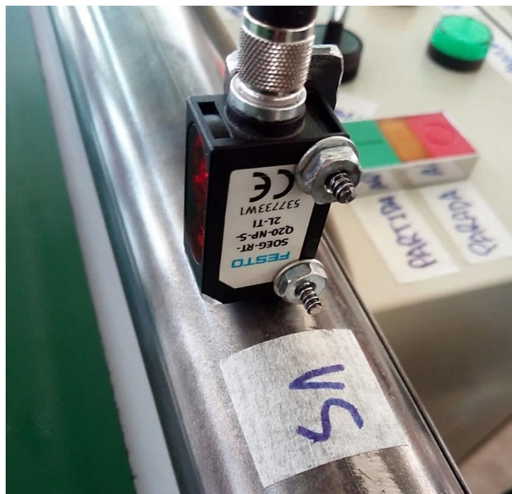
Figura 7.38: Sensor reflector SOEG-RT-Q20-NP-S-2L-TI instalado.
