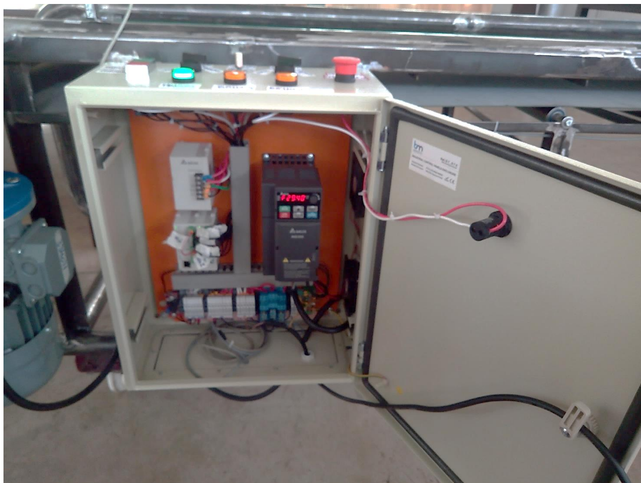
Figura 8.13: Panel eléctrico del banco de automatización de la Cinta Transportadora, vista 1.
