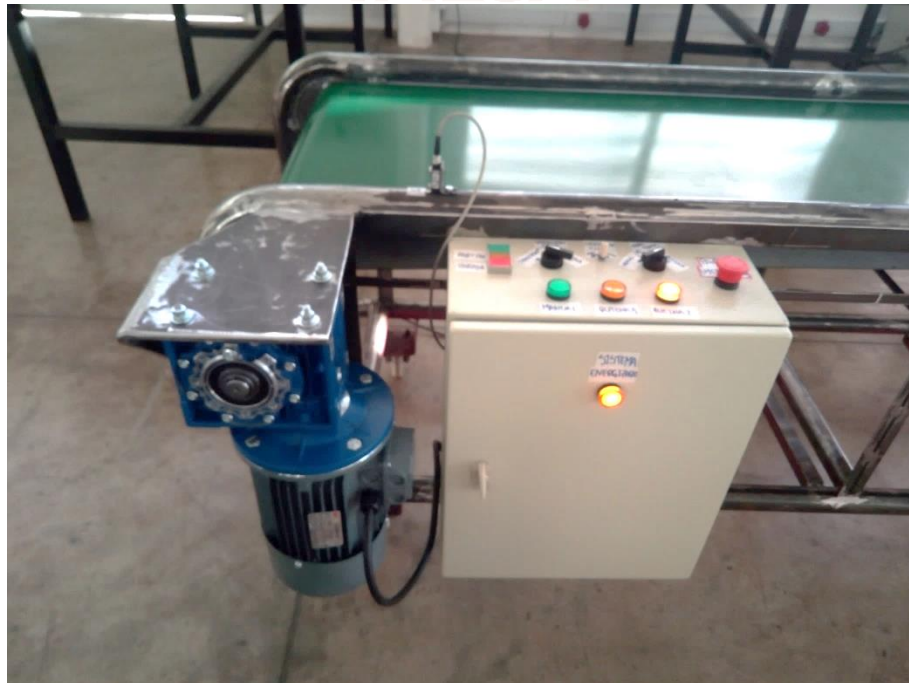
Figura 7.9: Motorreductor instalado en la Cinta Transportadora, Vista 2.
