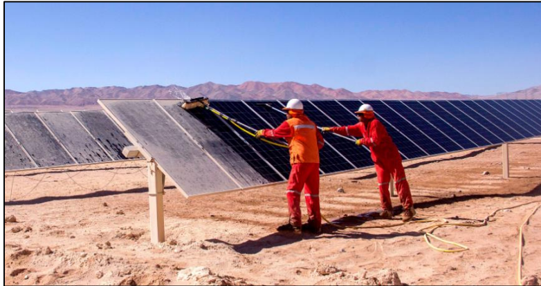
Ilustración 9: Limpieza manual de paneles fotovoltaicos. Fuente www.servi.cl .
