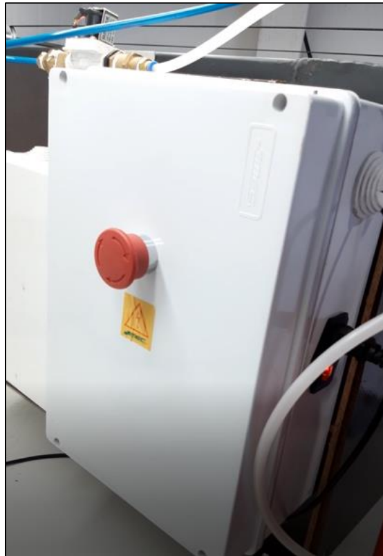
Ilustración 64: Caja estanco, componentes electrónicos y parada de emergencia. Fuente: Elaboración propia.
