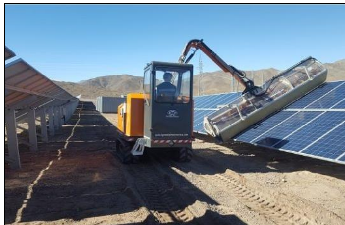
Ilustración 11: Sistema de limpieza de paneles fotovoltaicos por rodillos. Fuente: Estación minera.
