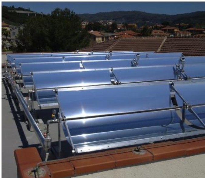
Figura 2-5: Colectores fototérmicos “Solar Wing EVO”. Fuente: Trivelli Energía srl.
