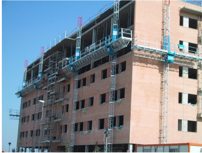
figura N°26: Elevador de plataforma bimastil
