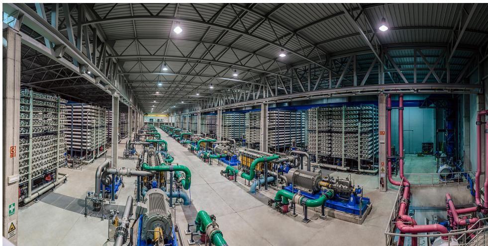
Figura 13: Planta Desaladora IDAM Torrevieja, España.
